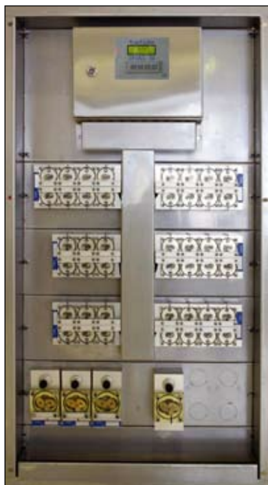
Mätartavla Metering panel
